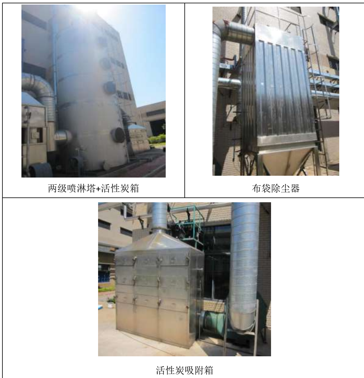
图 4.1-2 废气治理设施图
